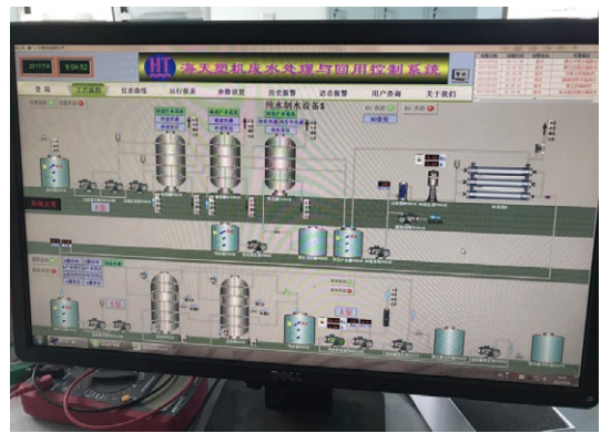
廢水處理與回用控制系統
