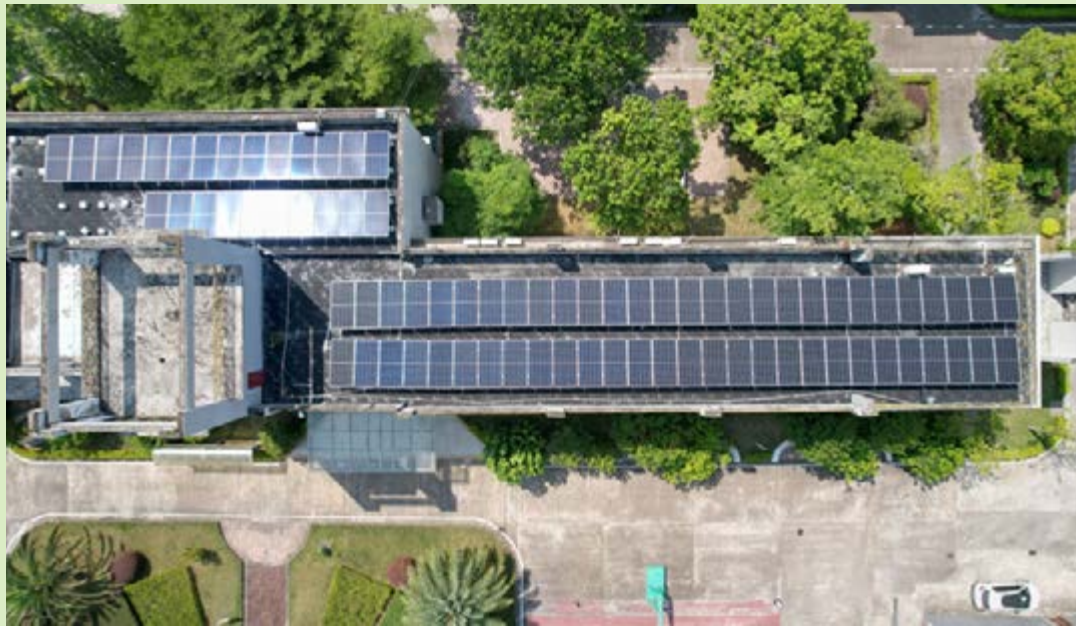
蒼郁公司分布式光伏發電項目
