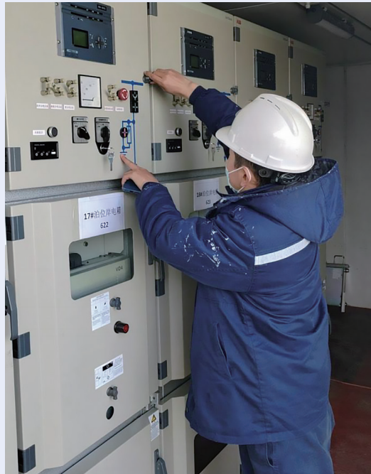
圖：員工在岸電機房內進行操作
