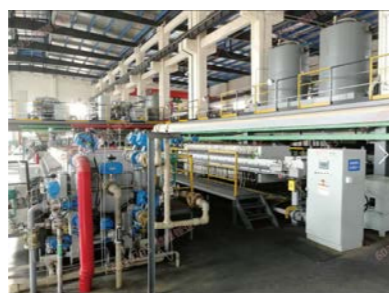
含鋰溶液淨化除雜車間
