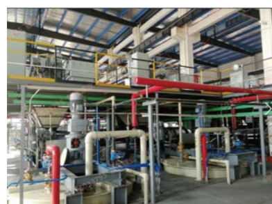
含鋰廢渣歸一化後處理車間
