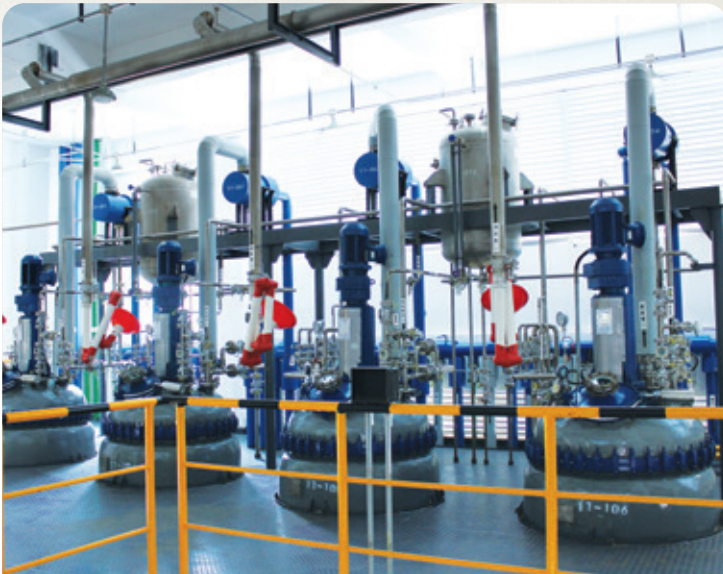
重慶康樂製藥有限公司三車間303生產線搪玻璃反應罐，用於替加環素產品生產 Chongqing Kangle Pharmaceutical Co., Ltd.* 303 production line glass-lined reaction tank for producing tigecycline products
