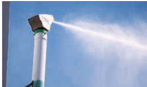
Fog-pile dust suppression system 霧樁抑塵系統
