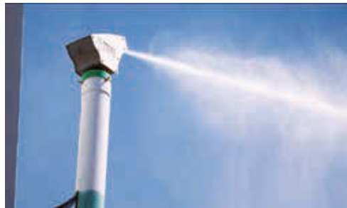
Fog-pile dust suppression system 霧樁抑塵系統
