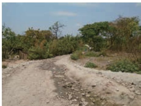
道路侵蝕狀況
