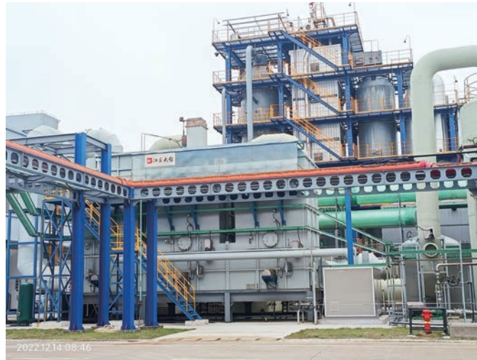
三室RTO設施
