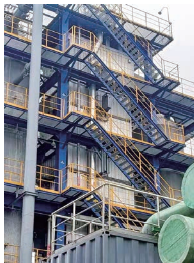
廢液焚燒裝置餘熱鍋爐
