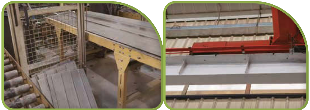
設備安全防護罩及天車接地線保護措施
