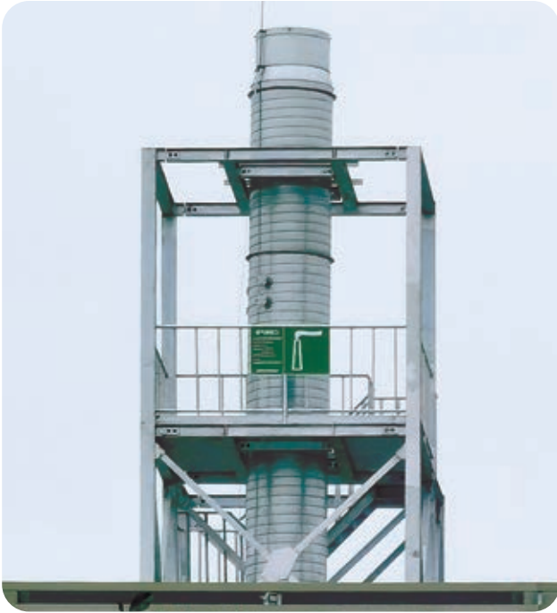
有機廢氣處理煙囪
