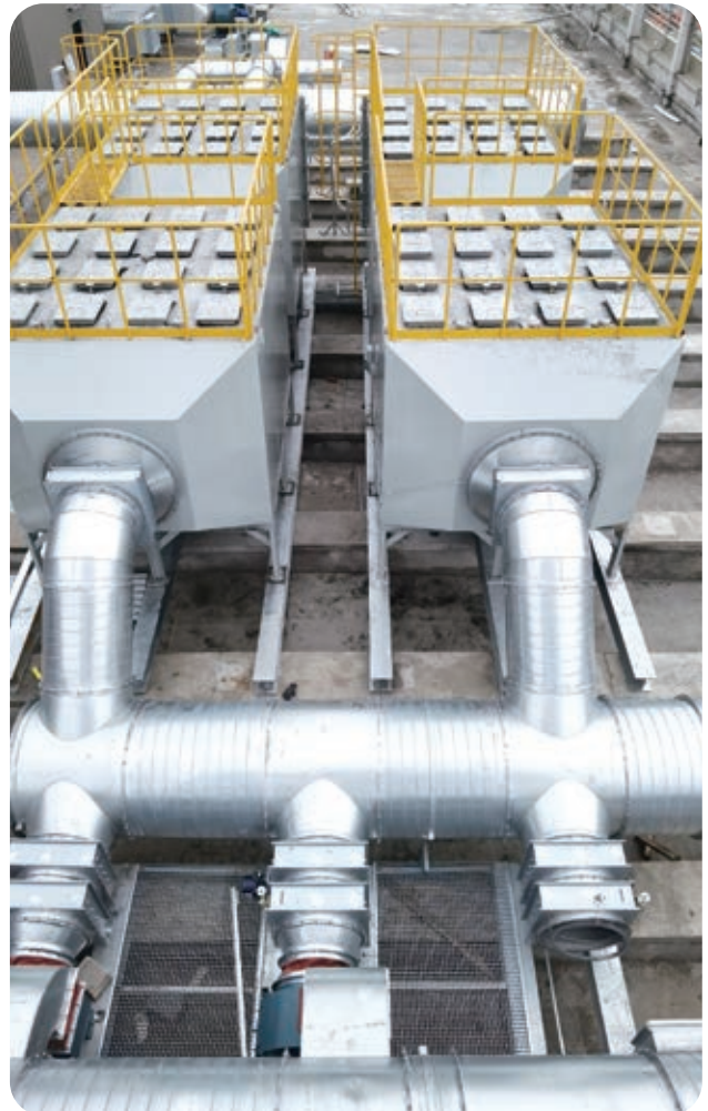
有機廢氣處理活性炭塔
