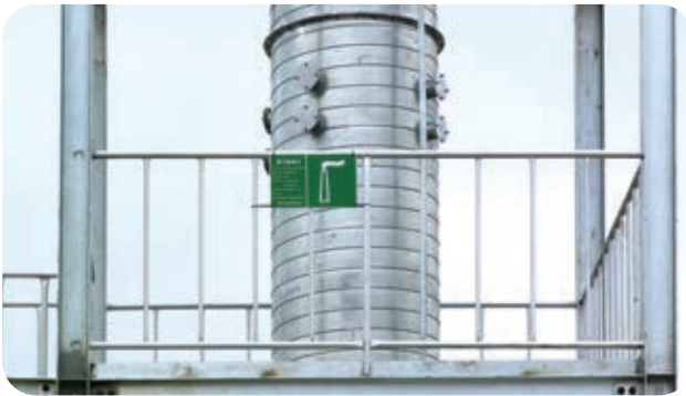
有機廢氣煙囪
