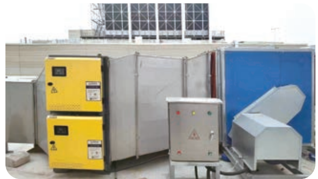
廚房油煙處理裝置
