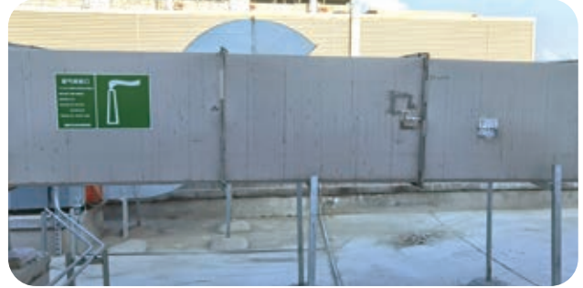
廚房油煙排放口
