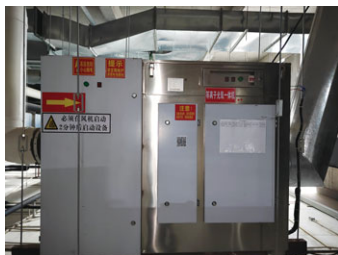
車間有機廢氣處理設備
