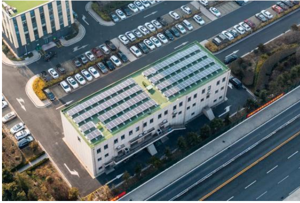
建築物頂部光伏項目投用
