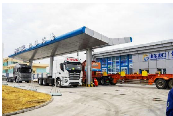
前灣港區加氫站
