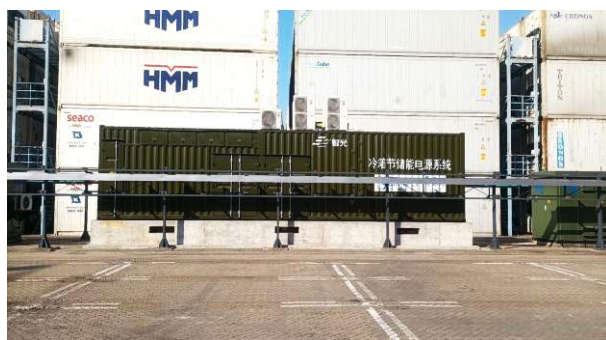
冷箱堆場變頻儲能設備
