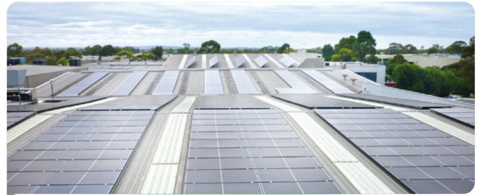
● Keysborough 廠址於二零二二年裝設太陽能板系統
