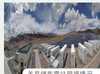
羊易儲能電站現場情況
