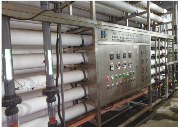
反滲透純水設備
