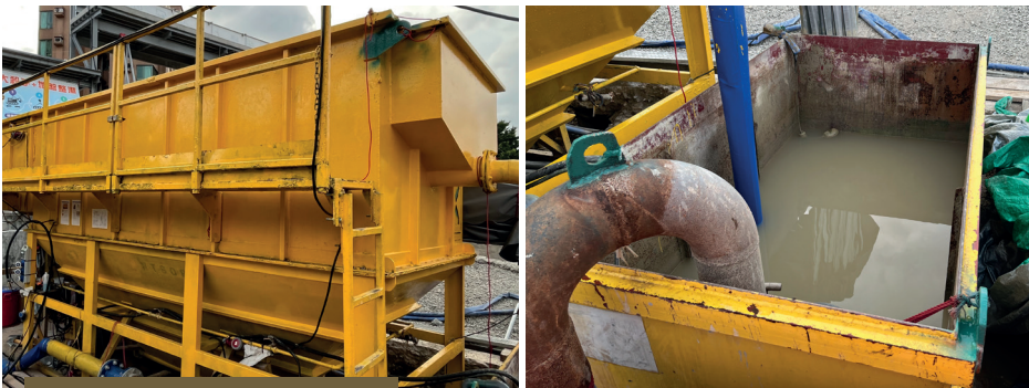
在沉澱池進行初步沉澱
