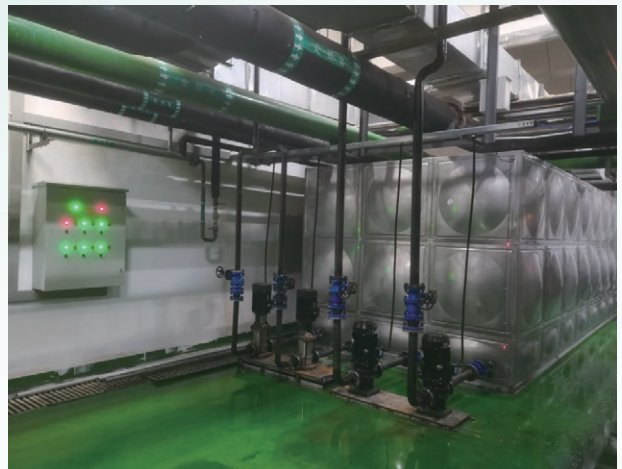
吉林津升水資源回收再利用裝置
