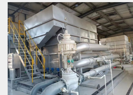
月東油田新設浮選機 及浮選機間
