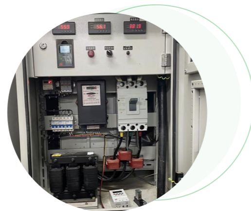
月東油田於變頻加熱櫃中安裝時控開關
