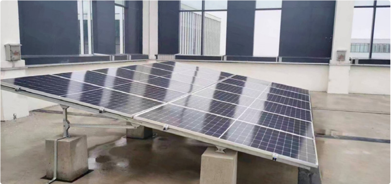
中國工業地產平台的園區高層的光伏設備
