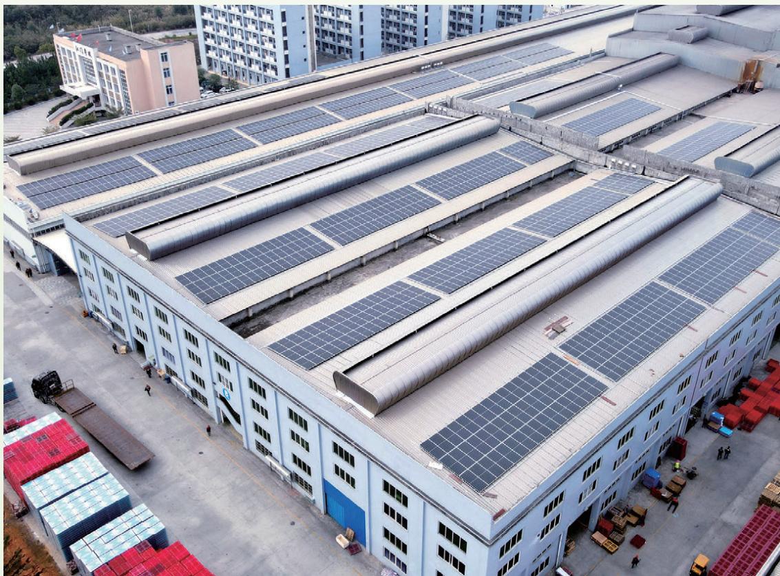
粵玻實業公司廠區屋頂光伏系統
