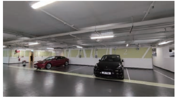
Electric vehicle charger 電動車充電器
