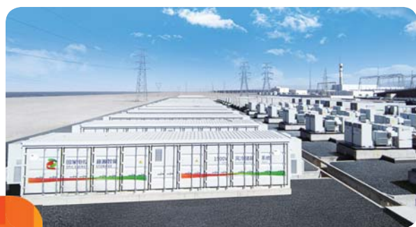
青海格爾木共享儲能電站示範項目
