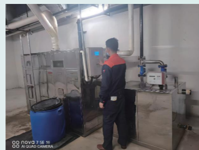
工作人員調整隔油處理設備運行時間
