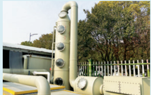
新增廢氣收集處理裝置
