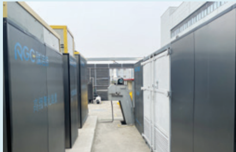
新增污水水質提升裝置
