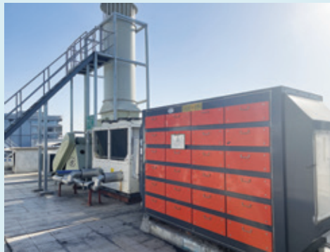
廢氣收集及處理裝置
