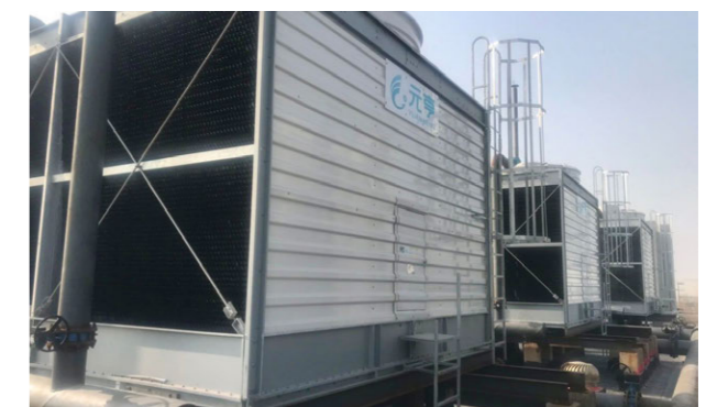
天津廠區節能水塔
