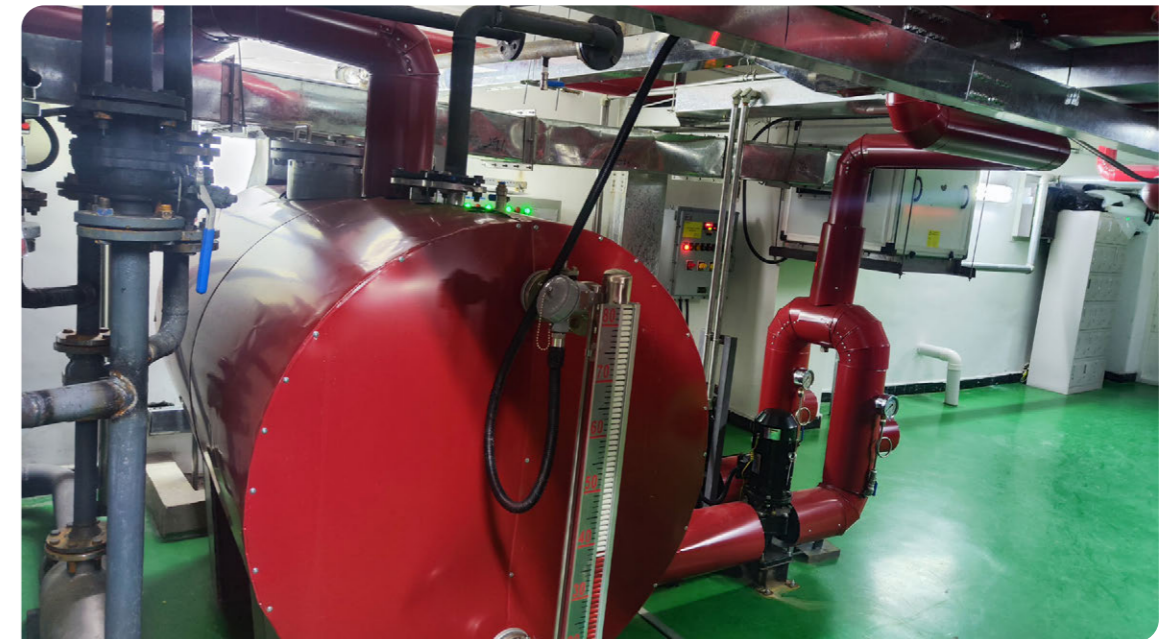
敦化廠區冷凝水回收設備
