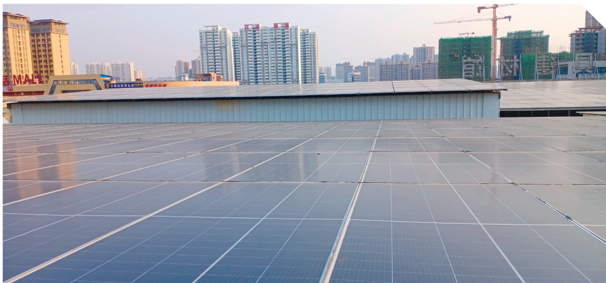
南寧大商匯項目引入光伏發電
