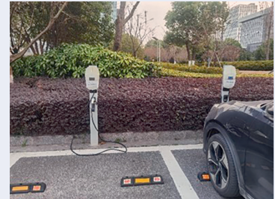
新能源電動汽車充電樁
