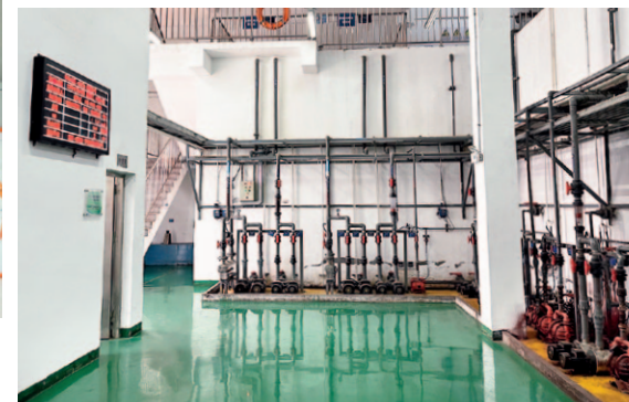
在中國江門廠房的廢水處理設施
