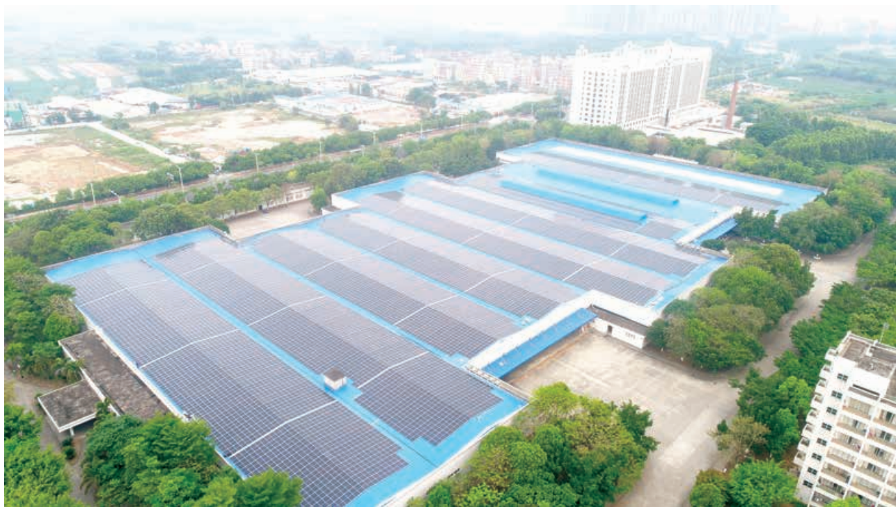
惠州廠房第一期光伏發電設施
