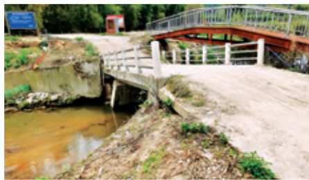
洪水損壞的危橋
