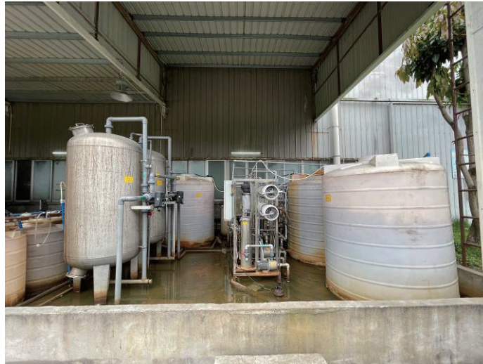
Sewage treatment system 污水處理系統
