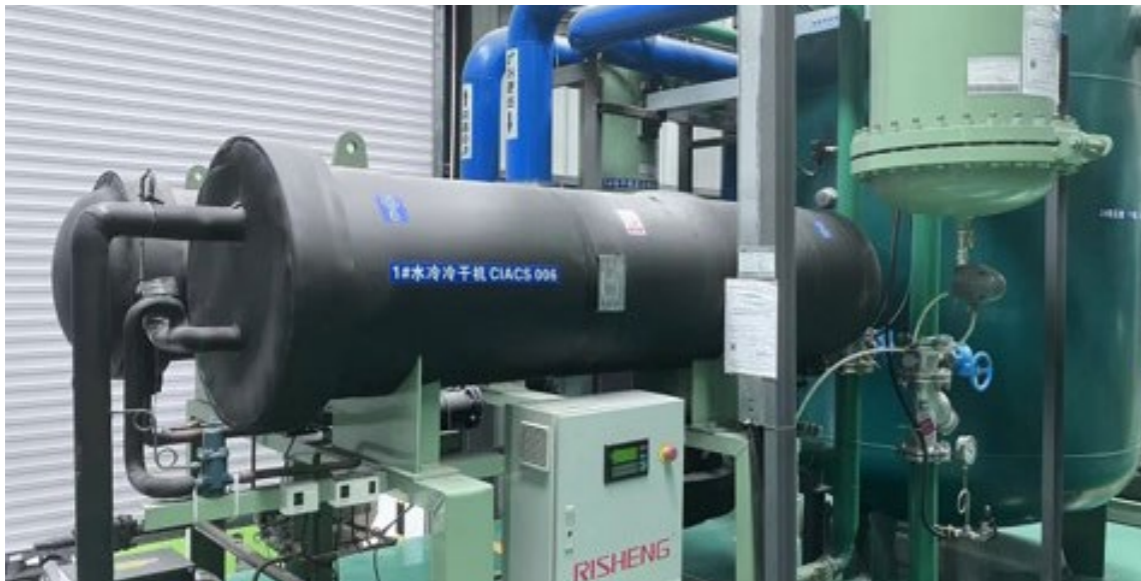
上海汽玻離心空壓機站節能改造
