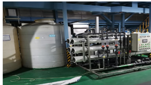
福清鋁件塗裝車間使用原水製備純水，降低自來水用量
