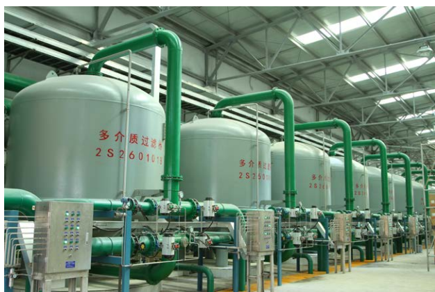
鄂能化公司废水处理装置
