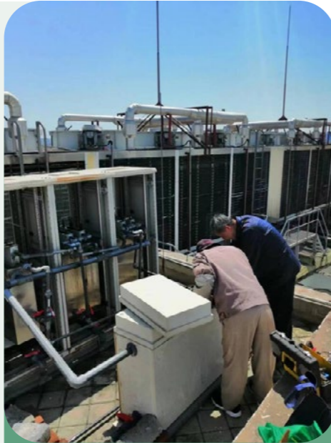
中央空调冷却水处理设备
