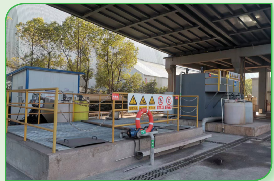
污水處理設備
