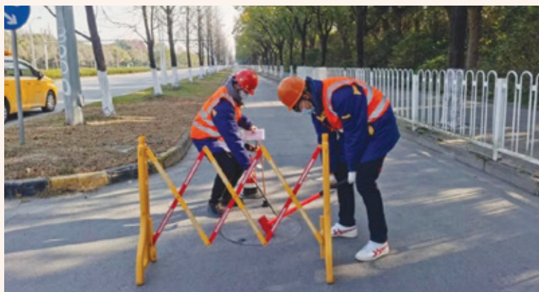
上海大眾燃氣燃氣巡檢現場
