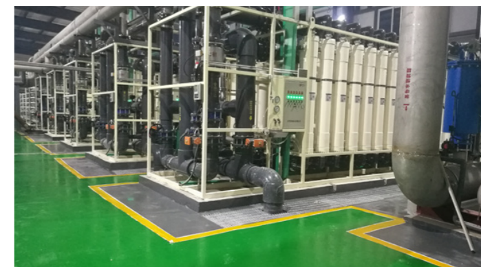
▲ 公司北大沟污水处理系统
