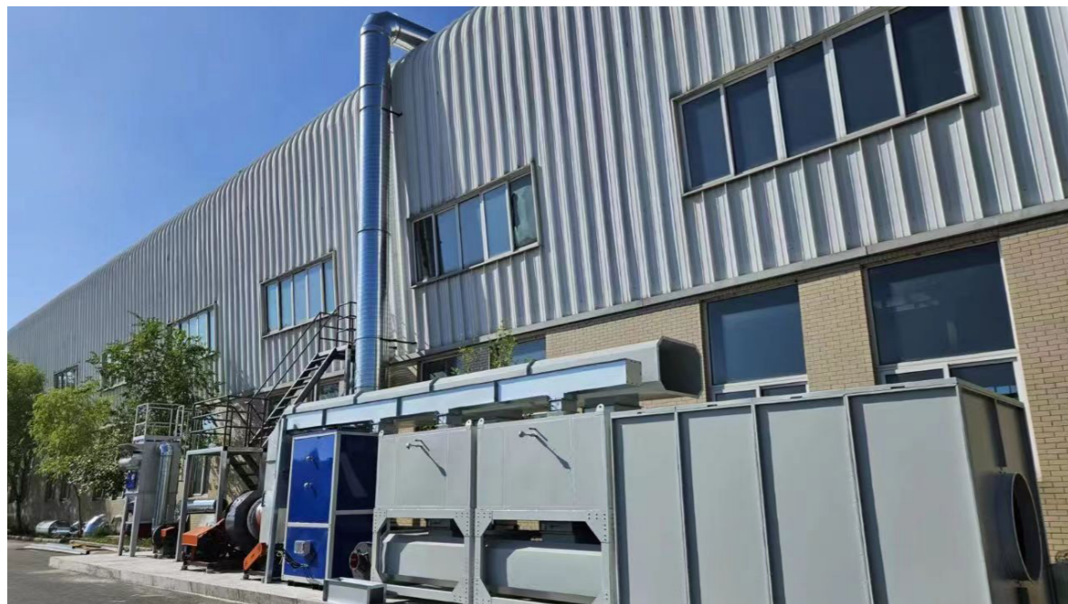
廢氣處理裝置
