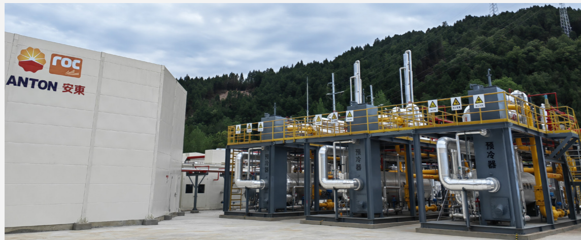
| 安東國內首個天然氣處理智慧場站 BOT 項目全面投產
