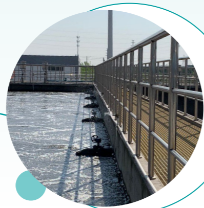
污水處理廠生化池噴淋裝置
