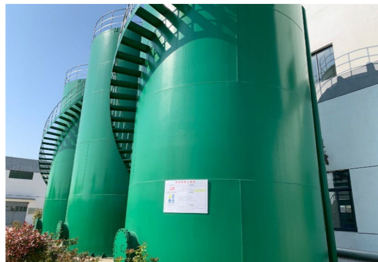
泰興市黃橋工業園區污水處理廠中水水箱
