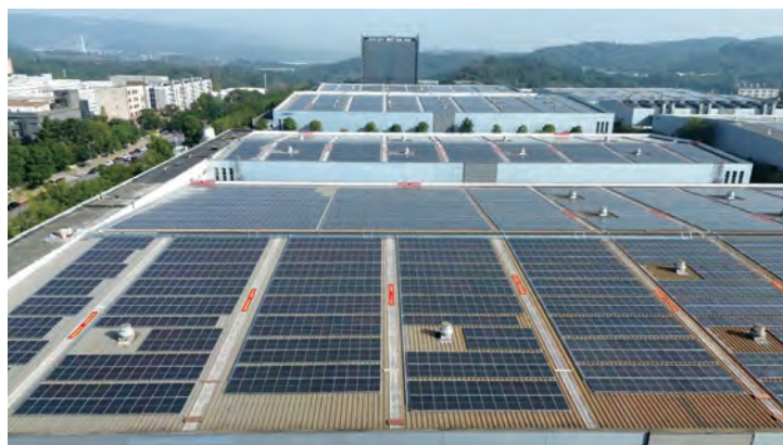
Photovoltaic Project of Machine Tool Group 機床集團光伏專案
