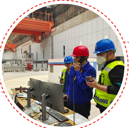
东方电机现场服务团队正在进行首台机组试运行调试
