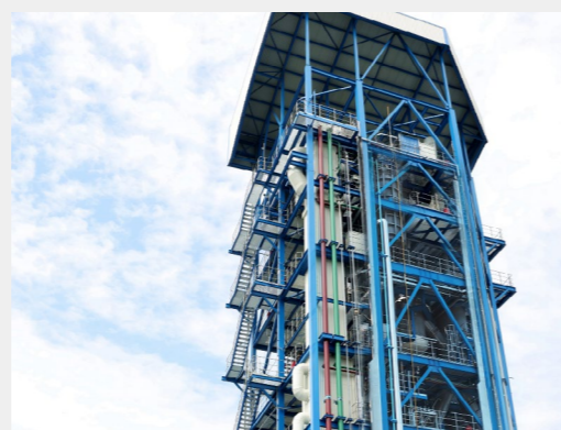
全球最大 4MWth 化学链燃烧示范装置
