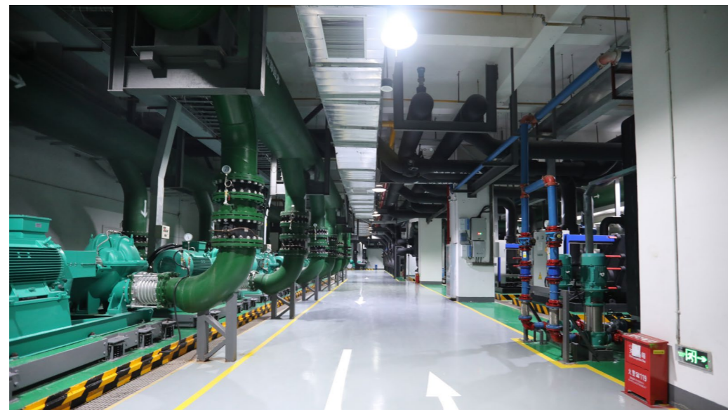
中電節能源站內景
