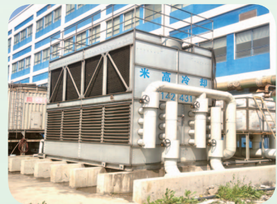
冷卻塔優化後
