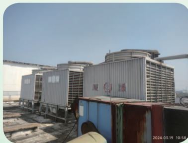
冷卻塔優化前
