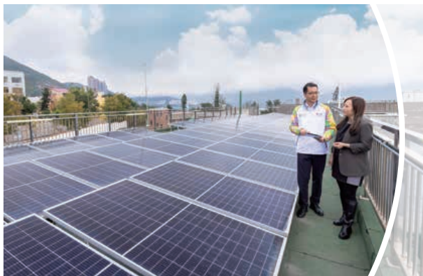
位於香港赤柱的過渡性房屋計劃「尚晉坊」參與港燈的「上網電價計劃」，在大廈屋頂安裝太陽能發電系統。
