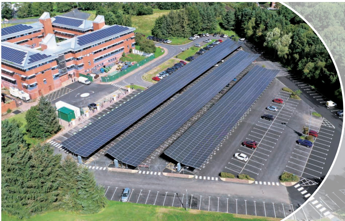
UKPN 為 Northumberland 郡議會新建的太陽能停車場提供專業電力服務，並為鄰近的議會大樓提供電力。
