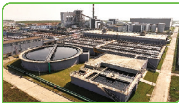
Sewage treatment system of Vietnam subsidiary 越南子公司污水處理系統
