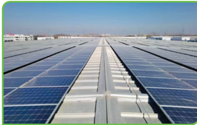
Rooftop photovoltaic power generation project of Xuzhou subsidiary 徐州子公司屋頂光伏發電項目
