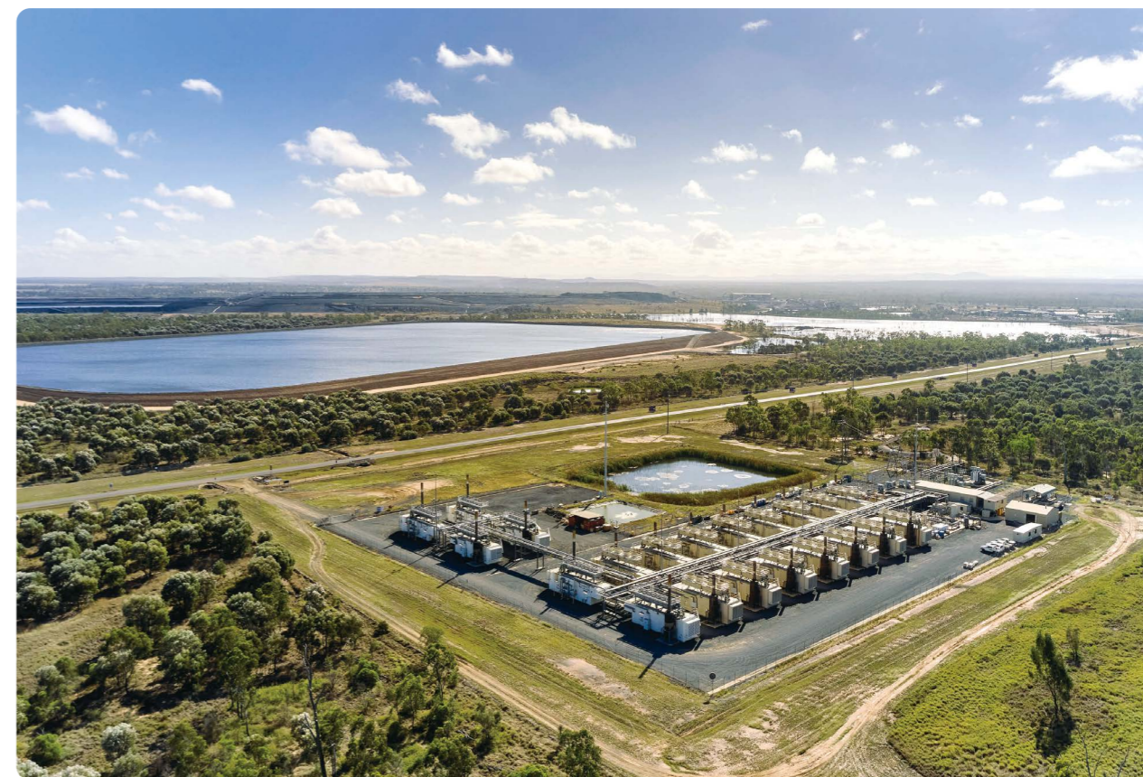
EDL擁有並營運64兆瓦的Moranbah North煤礦廢氣發電站，這個發電站專門收集並燃燒來自煤礦的廢氣，並將其轉化為供國家電網使用的電力。
