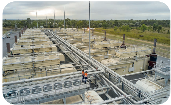
EDL 的廢棄煤礦氣體發電站
