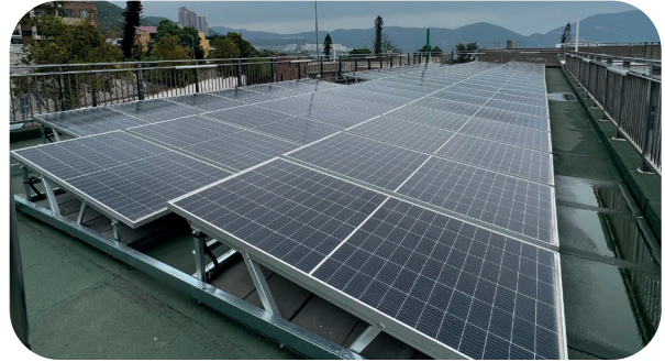
港燈於「尚晉坊」過渡性房屋安裝的太陽能板
