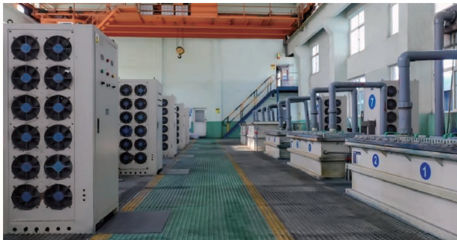
金翅嶺金礦水處理系統
