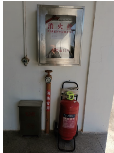
生產車間設置消防器材
