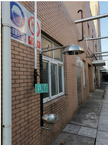
車間與倉庫區域配備洗眼器
