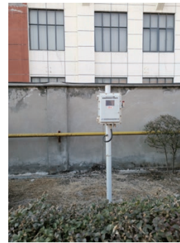
廠區配備大氣VOCs監控設備
